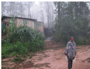
Huisje mist deel dak na cycloon Hanna
